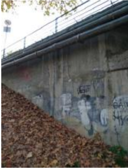
Εικόνα 5 Εμφανής ρωγμή στο νοτιοδυτικό ακρόβαθρο
