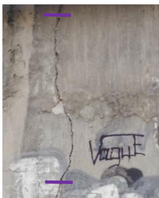
Εικόνα 3 Τοποθέτηση μετρητών ρωγμής (crack meter, μώβ) στο άνω και κάτω μέρος της ρωγμής στη νοτιοδυτική αντιστήριξη
