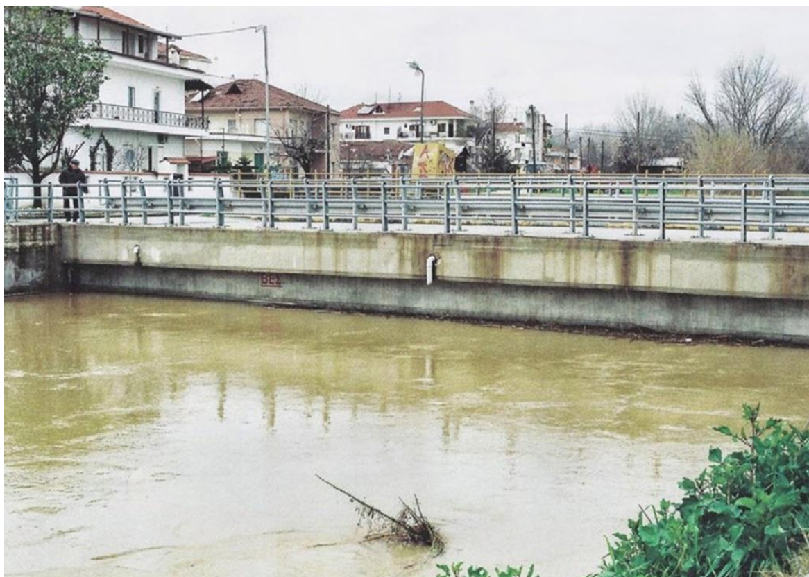
Εικόνα 5. Το χαμηλό ύψος της πιο πρόσφατης γέφυρας Αρριανού σε συνδυασμό με τις τεχνικές αστοχίες του θυρο-προφράγματος δημιουργούν φαινόμενα υπεσυγκέντρωσης ύδατος αντάντη τους
